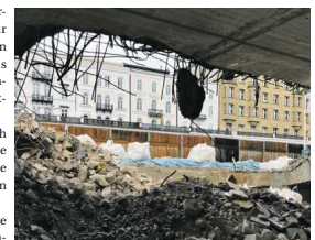
Im Februar 2020 rollten die Bagger an. Seitdem läuft der Umbau, der die Rathauspassage zur Freude der Betreiber und Unterstützer ans Licht befördert hat.
